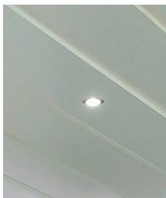
Éclairage spots dans les lames.
