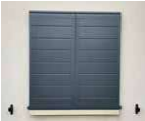
Absence de rail visible en façade
